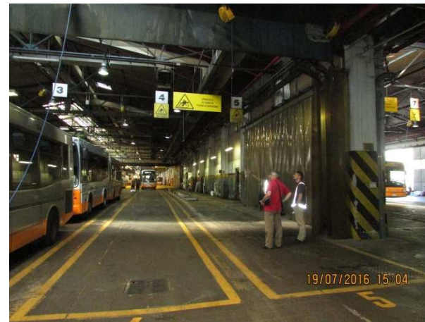
FOTO 4– Insieme Capannone (Riflettori Industriali e Plafoniere stagne su setto di separazione)
