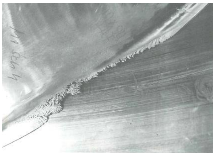
Fig. 9.85. Destruction de la collerette de bout de pale d'une roue Kaplan
